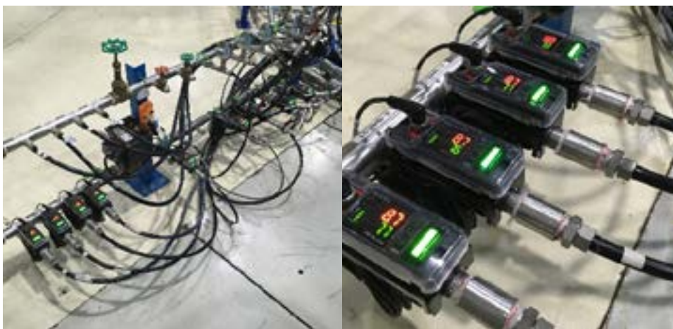
รูปที่ 7 ชุดระบบจ่ายน้ำหล่อเย็นแม่เหล็ก(ใหม่) และมิเตอร์วัด อัตราการไหลของน้ำหล่อเย็นแบบดิจิตอล
