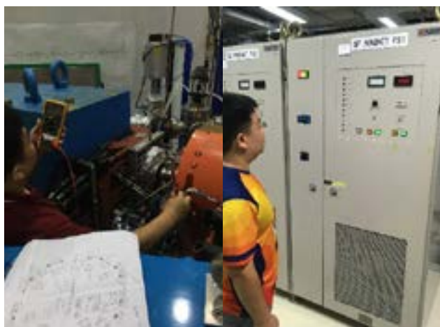
รูปที่ 5 การตรวจสอบการทำงานของวงจรอินเทอร์ล็อก ที่ใช้ตัดต่อการทำงานแหล่งจ่ายกำลังไฟฟ้าของแม่เหล็กสี่ขั้ว
