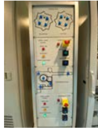
รูปที่ 66 การแสดงผลผ่านกราฟฟิคหน้าตู้ควบคุมของระบบความปลอดภัยบุคคล
