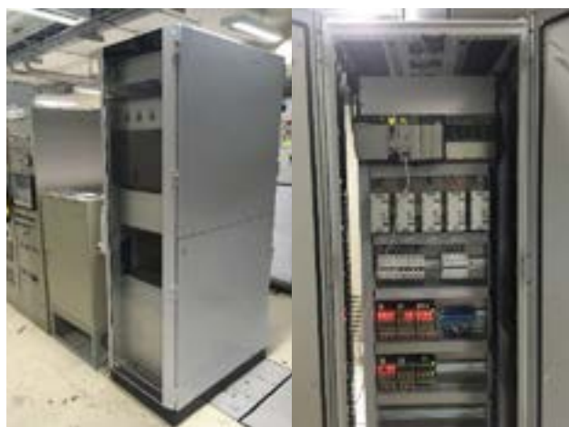
รูปที่ 6 ตู้ควบคุมการทำงานของระบบแสดงผลและตรวจวัด อัตราการไหลของน้ำหล่อเย็นบริสุทธ์ สำหรับระบบแม่เหล็ก ภายในวงกักเก็บอิเล็กตรอน
