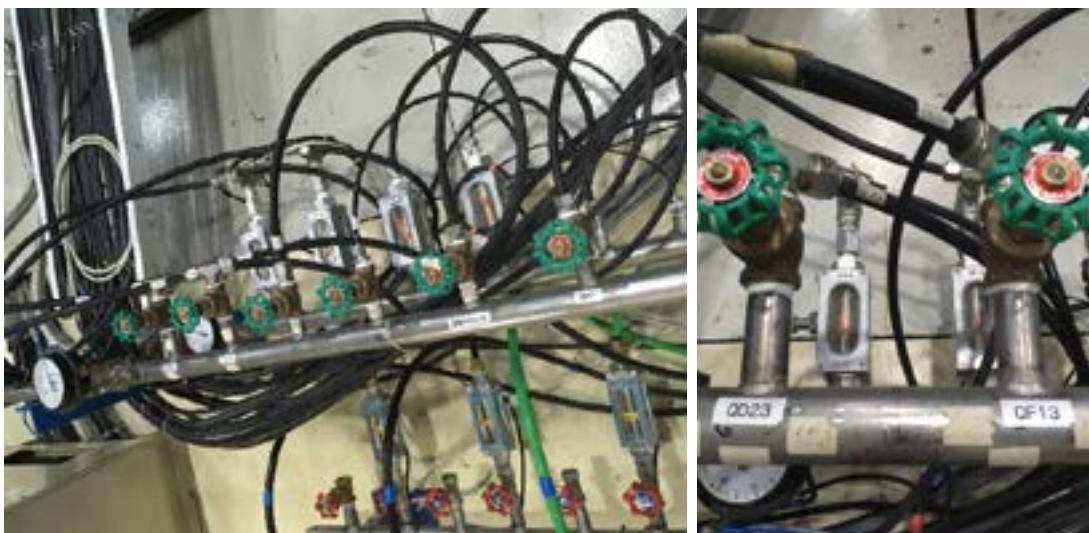
รูปที่ 2 ชุดระบบจ่ายน้ำหล่อเย็นแม่เหล็ก (เดิม) และมีเตอร์วัดอัตราการไหลของน้ำหล่อเย็นแบบอนาล็อก
