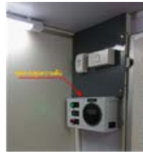
รูปที่ 56 ชุดควบคุมความดันภายในตู้ความดันบวก
